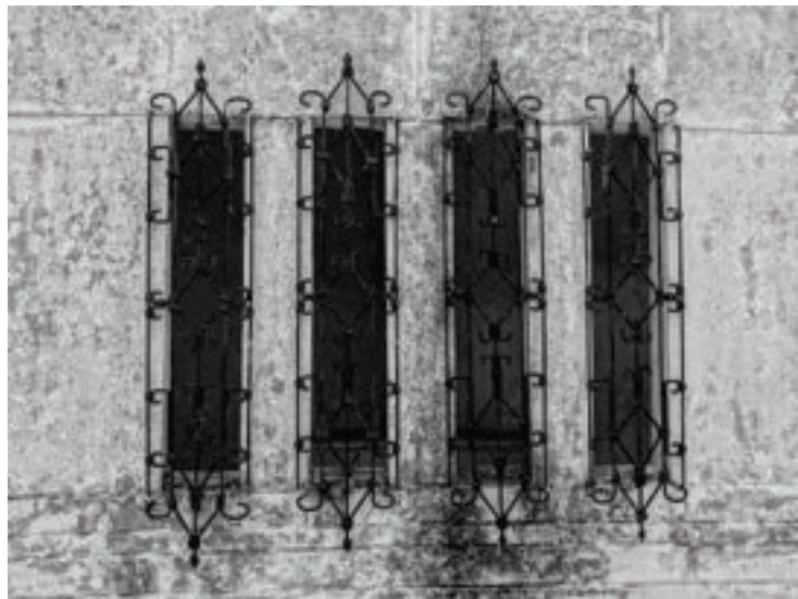
Imagen 638. Detalle rejas de las ventanas mausoleo B7-10. Fuente: Alfonso Javier López M.
