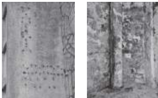
Imágenes 337 y 338. Detalles substracción de tipografía y humedad en la cubierta mausoleo P49-1. Fuente: Alfonso Javier López M.
